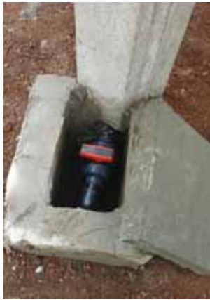
Tête de puit du forage à Tsiviépé
