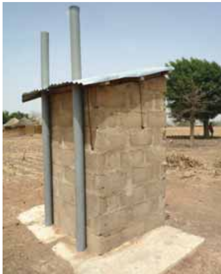
Latrine familiale double trou d'où double ventilation - vue arrière
