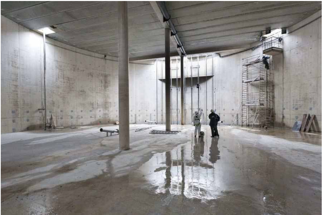
Bassin d'orage de Caudry vu de l'intérieur
